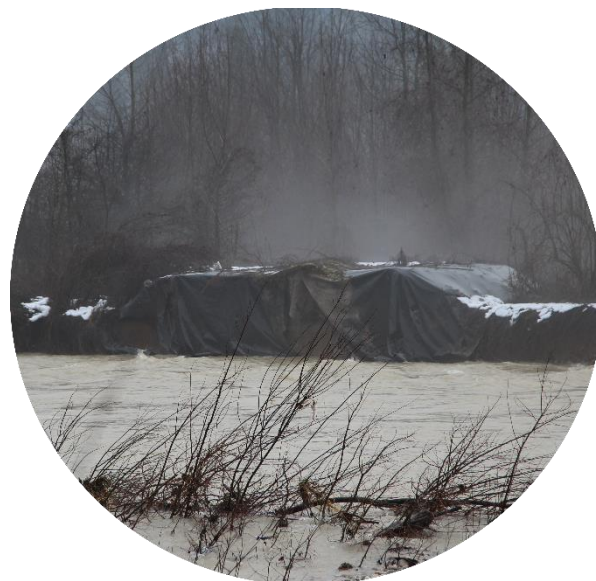
60 - Les matériaux (quid ?) protégés par cette grande bâche noire seront progressivement évacués dans la rivière.
