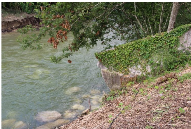
43 - Le mur et les blocs de protection effondrés par l'érosion régressive. Le mur d'enceinte d'une propriété repose sur le vide.
